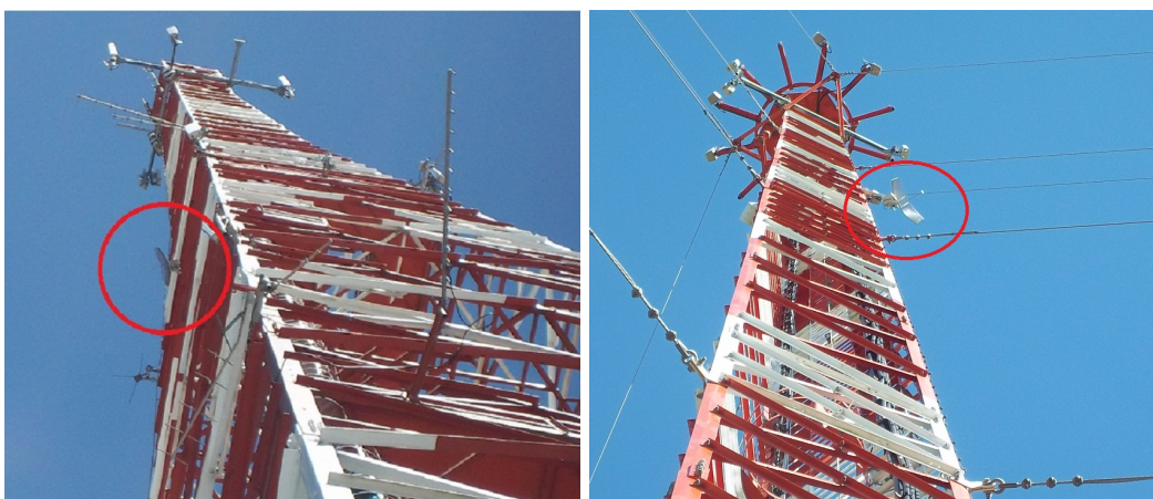
Figura 8.5: Imágenes de antenas GD58-29 instaladas en Florida (izq) y San Gabriel (der).
