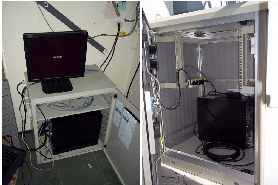
Figura 8.7: Gabinetes con equipos instalados en Florida (izq) y San Gabriel (der)
